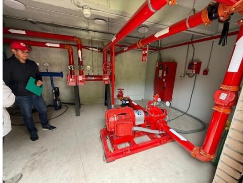
Fotografía 3. Verificación de sistemas contra incendios
